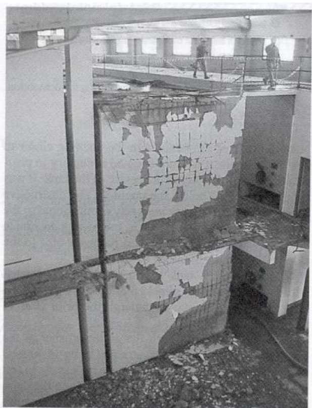
Δεξαμενές μετά την εφαρμογή της μεθόδου υδροανατίναξης, οι κολώνες του κτηρίου είναι ανέπαφες
