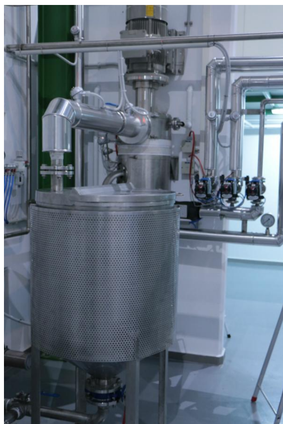
Τμήμα του δικτύου τροφοδοσίας ατμού
