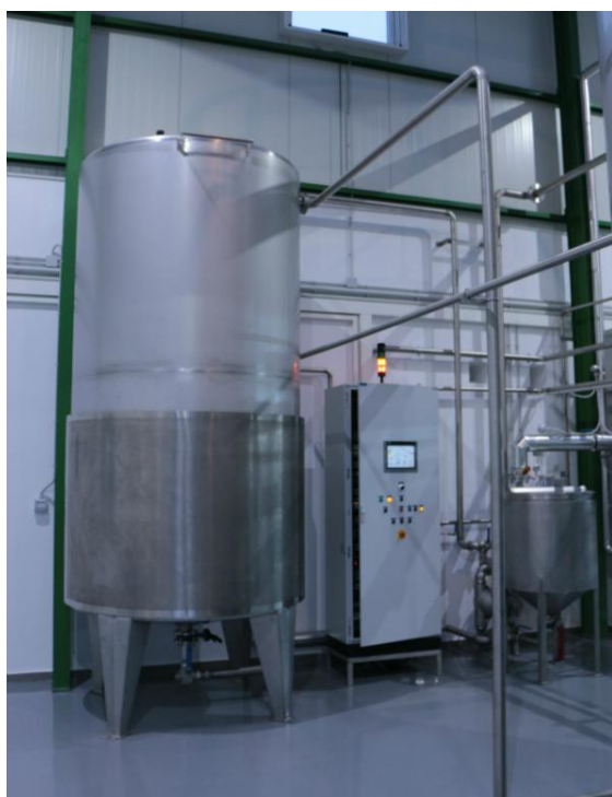
Εγκαταστάσεις έλεγχου λειτουργίας και δεξαμενών τροφοδοσίας
