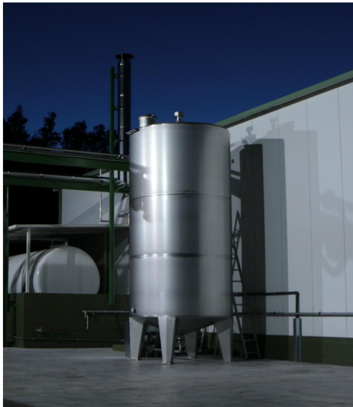
Τμήμα της εξωτερικής τροφοδοσίας και της εγκατάστασης της ατμογεννητριας Δεξαμενή αποθήκευσης matrix
