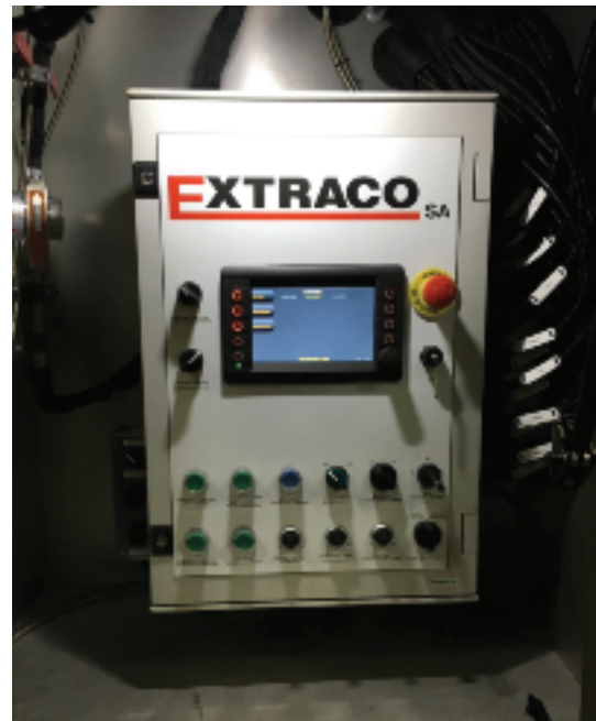
Πίνακας ελέγχου (PLC)
